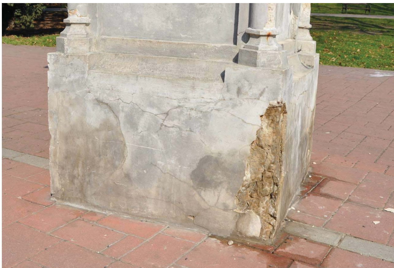
Meteosloupek-pohled na silně degradovanou soklovou část s opadávajícím tmelem a hloubkovými trhlinami
